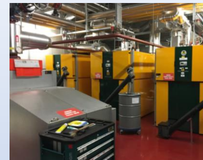
Chaudières à bois dans chaufferie
